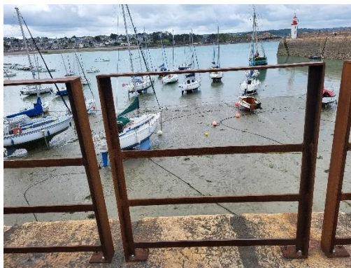
Garde-corps existant rue du Port ERQUY
