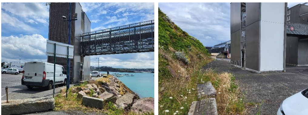
La végétation en haut de perré (proche ascenseur accès passerelle) ...et en pied de falaise (proche ascenseur descente passerelle)
